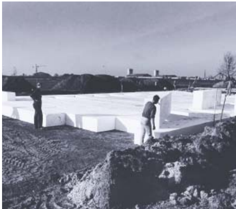
Reparatie oude zettingen.
