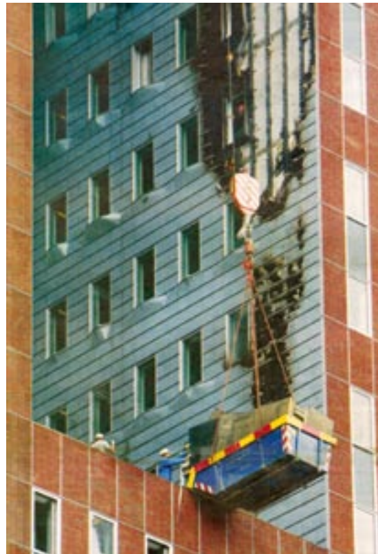
Een brandveiliger detail kostte € 1.800,-. De brandschade bij de Prinsenhof te Den Haag (september 2003) was ca. € 2,5 miljoen volgens de dakdekker.
