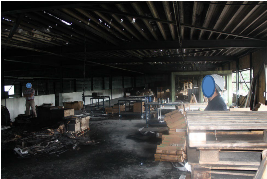
Abbildung 6 Sekundärbrand im Gebäude, verursacht durch brennendes Fallmaterial (Quelle: Feuerwehr Twente)
