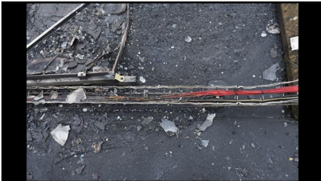
Abbildung 21 Schäden an den Kabeln (Quelle: Feuerwehr Gelderland-Midden)
