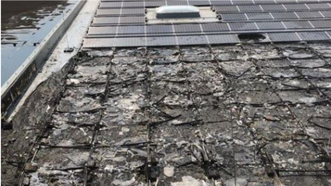
Abbildung 11 Schäden auf dem Dach von Gazelle (Quelle: www.omroepgelderland.nl )
