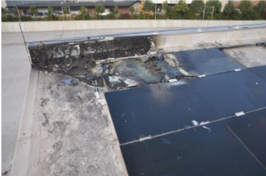
Abbildung 17 Der Brandschaden beschränkt sich auf einige Paneele und einen kleinen Teil des Daches.
