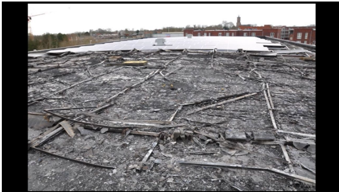
Abbildung 20 Schäden an der PV-Anlage und am Dach (Quelle: Feuerwehr Gelderland-Midden)
