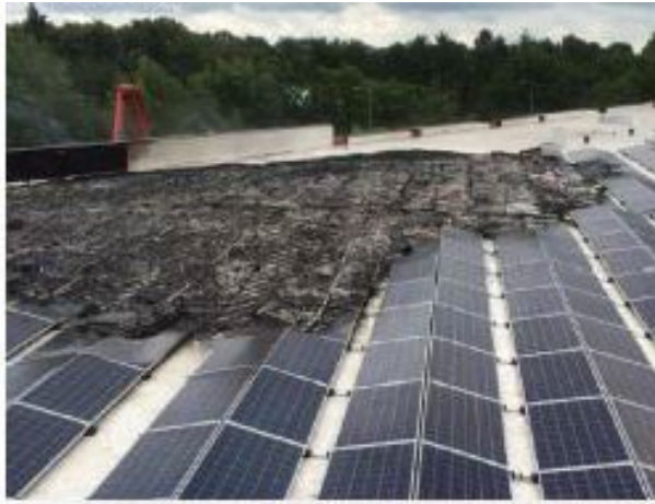
Abbildung 2 Überblick über die Schäden auf dem Dach (Quelle: unbekannt)
