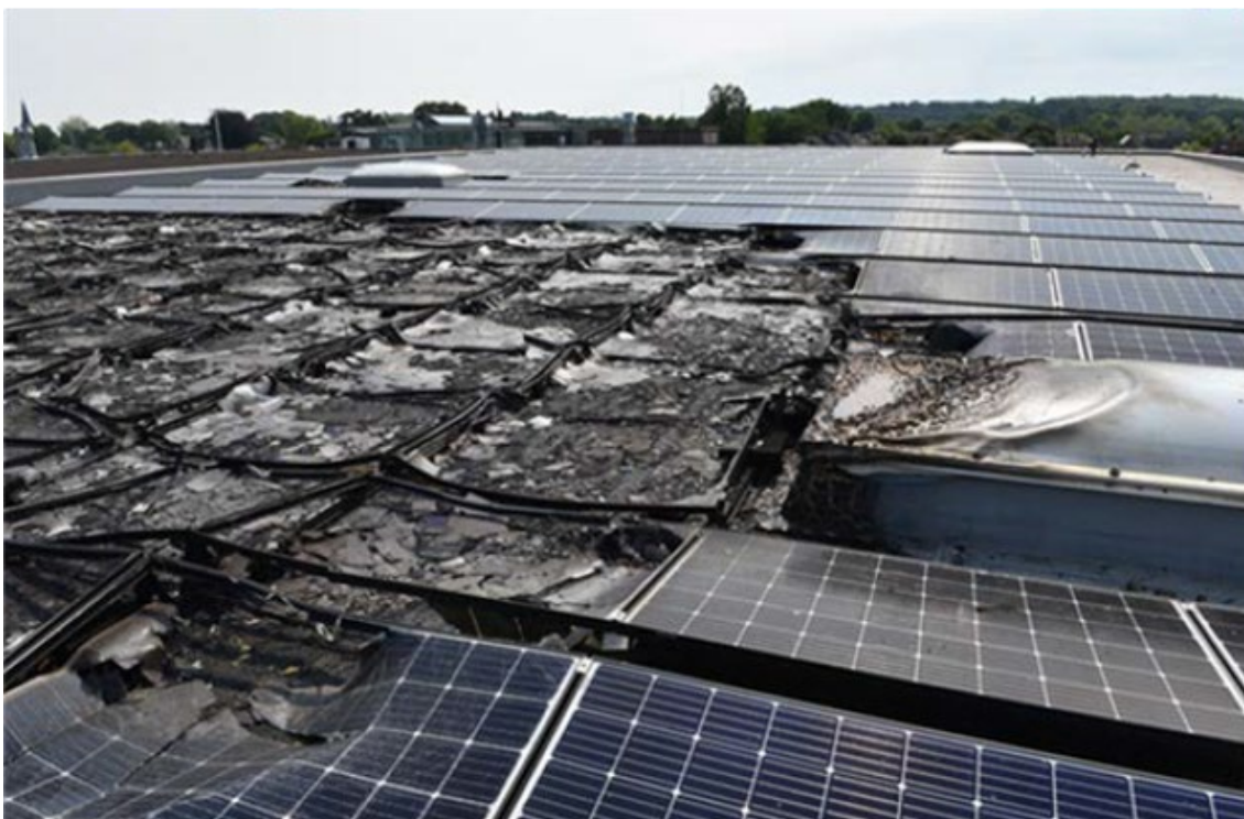
Abbildung 12 Schäden auf dem Dach der Gazelle, wo das Feuer ein Dachfenster erreichte (Quelle: unbekannt).
