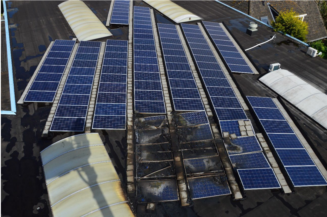
Abbildung 14 Schäden auf dem Dach (Quelle: TBO Fire Department Haaglanden)
