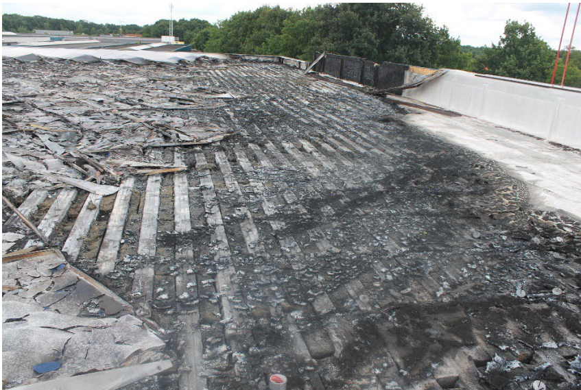
Abbildung 3 Schäden am Dach (Quelle: Feuerwehr Twente)
