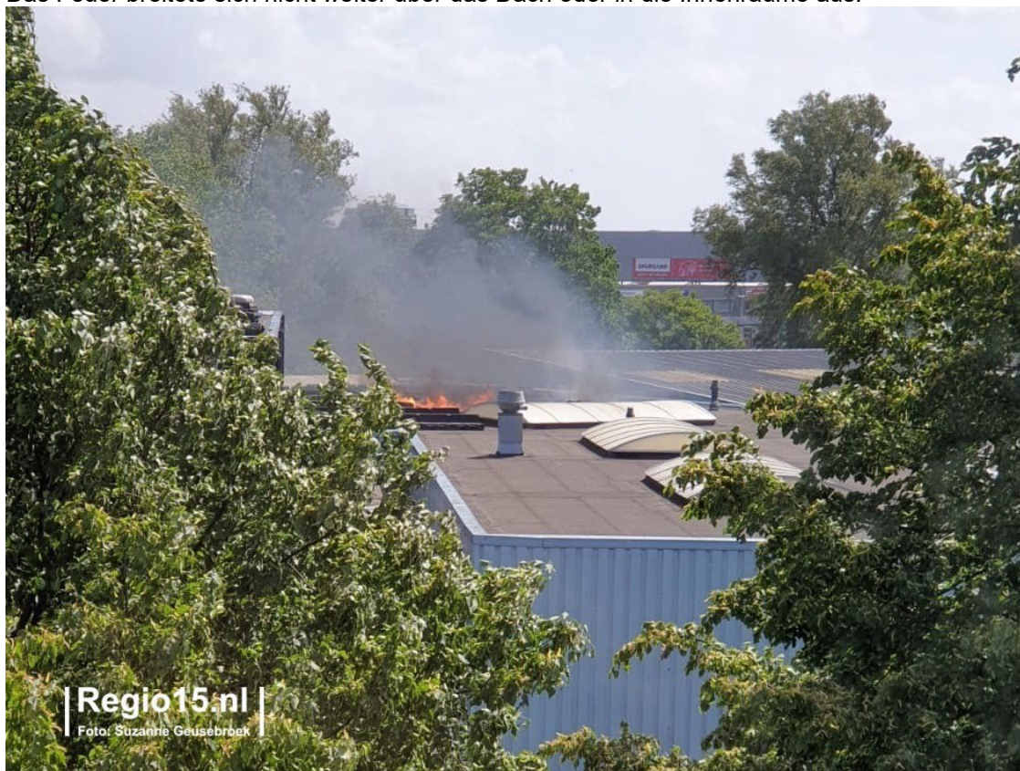
Abbildung 13 Feuer in den Sonnenkollektoren (Quelle: Regio15.nl)
