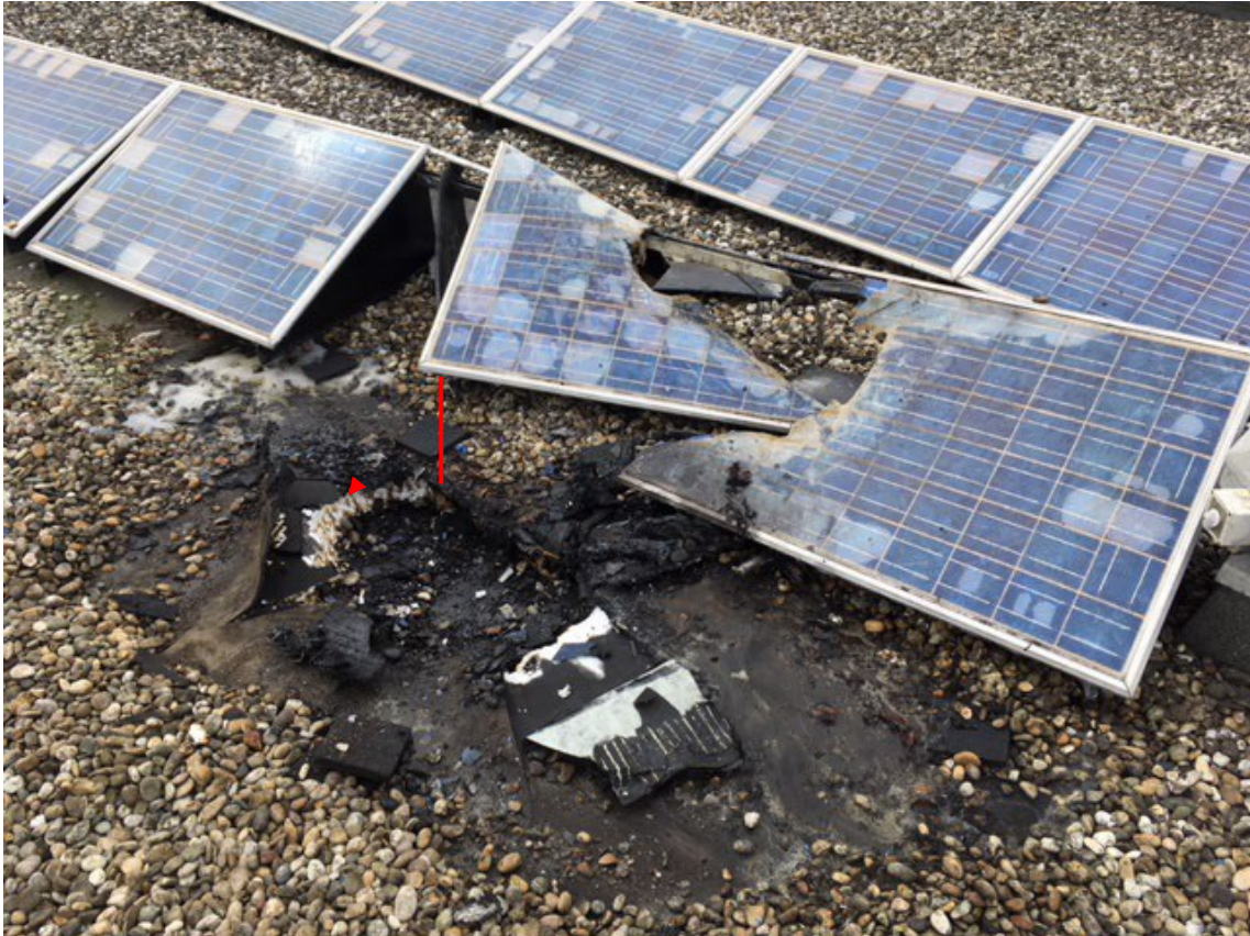
Abbildung 8 Schäden an Solarmodulen und Dach. Geschmolzenes EPS ist durch den roten Pfeil sichtbar. charakteristische "karamellisierte Tropfen" (Quelle: Gemeinde Opmeer)
