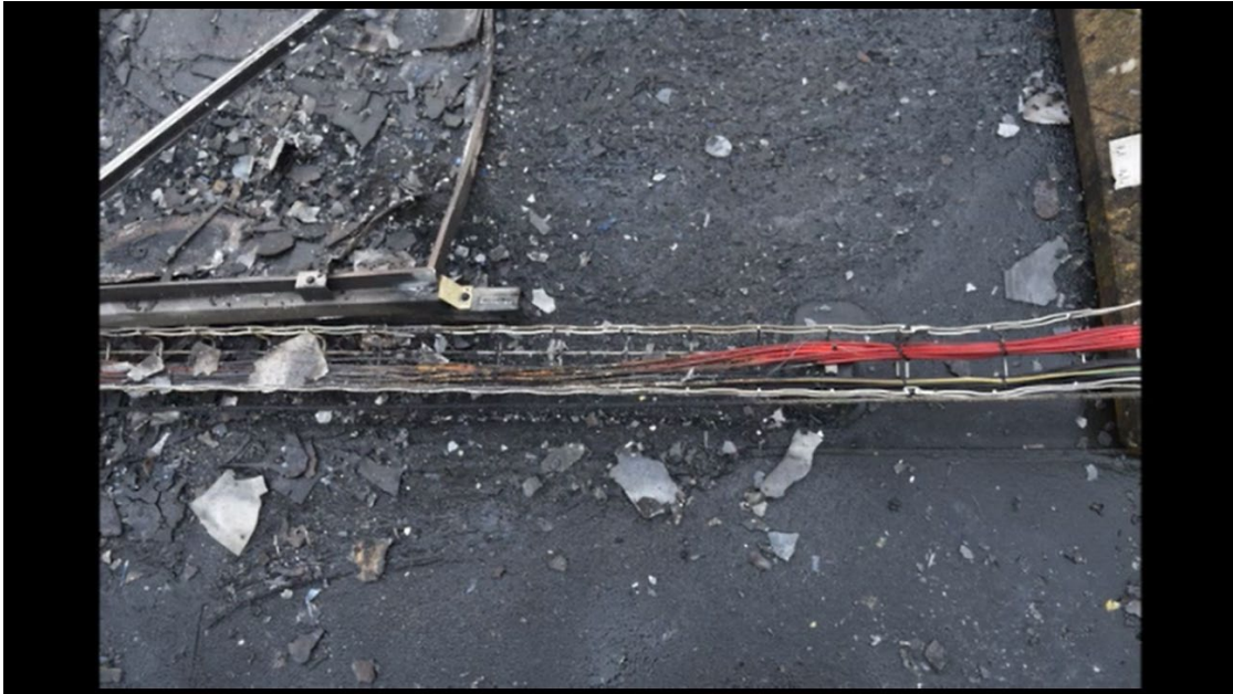
Abbildung 18 Schäden an den Kabeln (Quelle: Feuerwehr Gelderland-Midden)
