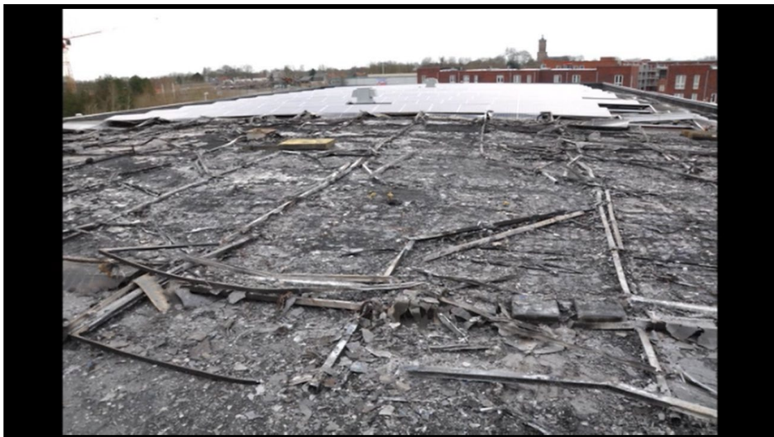
Abbildung 17 Schäden an der PV-Anlage und am Dach (Quelle: Feuerwehr Gelderland-Midden)
