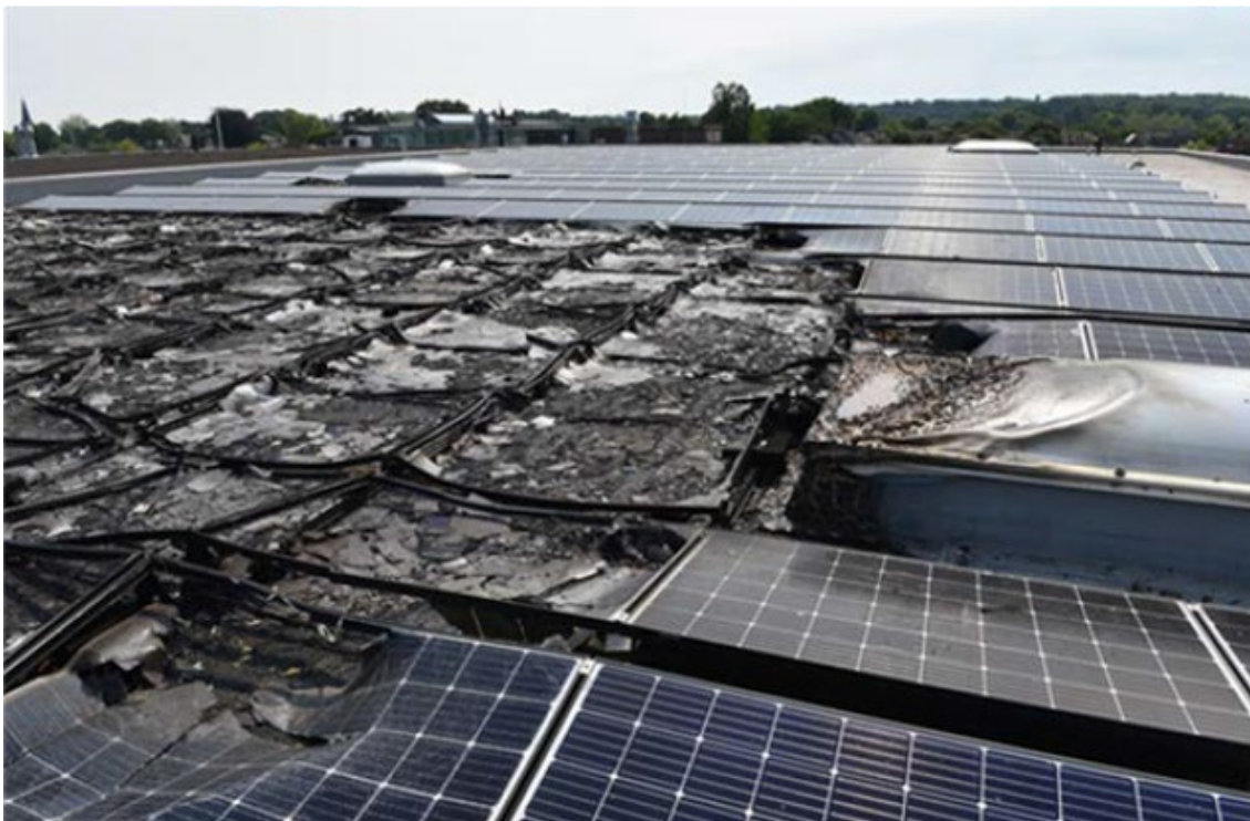
Abbildung 12 Schäden auf dem Dach der Gazelle, wo das Feuer ein Dachfenster erreichte (Quelle: unbekannt).
