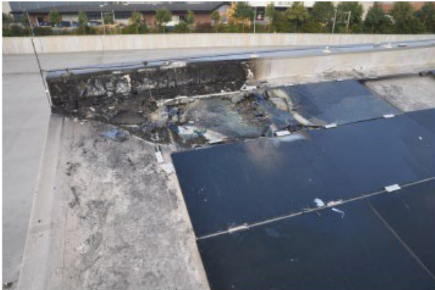
Abbildung 15 Der Brandschaden beschränkt sich auf einige Paneele und einen kleinen Teil des Daches.
