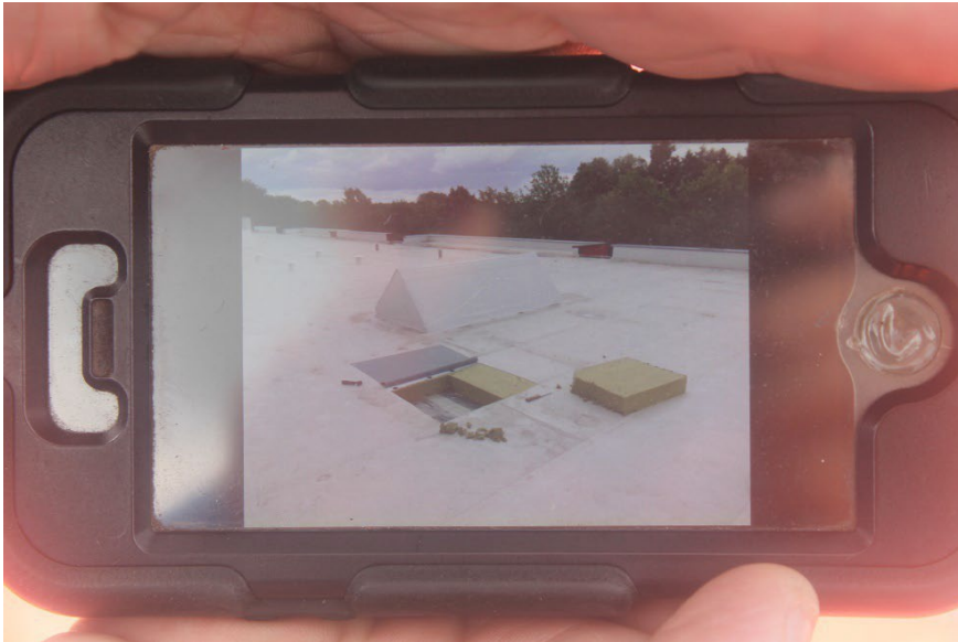
Abbildung 5 Das Dach ist an den feuerfesten Trennwänden mit Steinwolle unterbrochen, aber nicht mit einer Schicht aus Betonplatten bedeckt (Quelle: Feuerwehr Twente)
