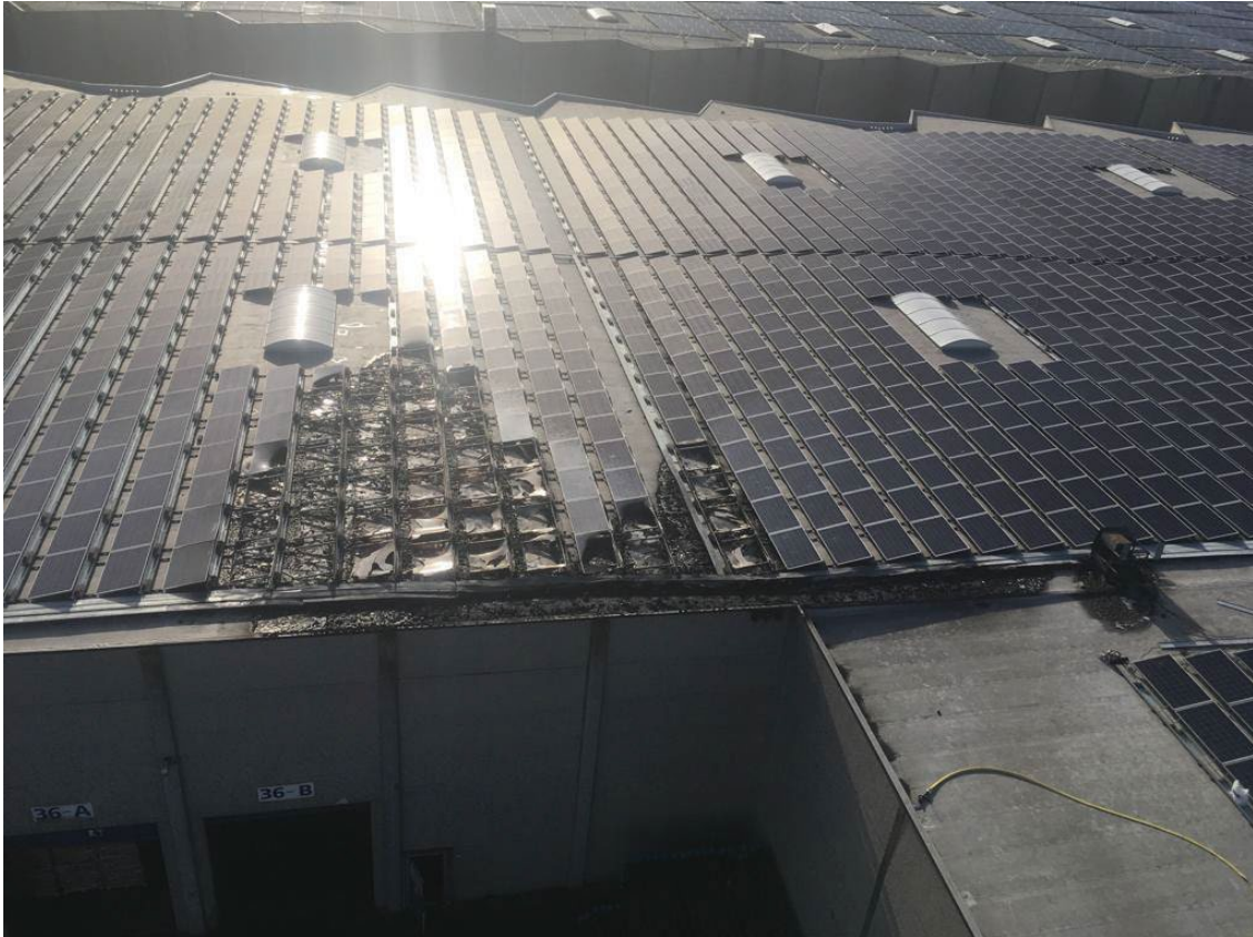
Abbildung 9 Schäden auf dem Dach der Lagerhalle (Quelle: Amsterdam-Amstelland Fire Service)
